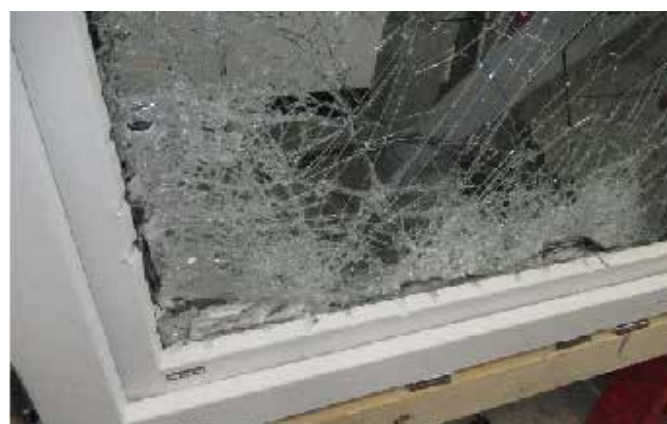
Uszkodzenia spowodowane testowaniem ręcznym
