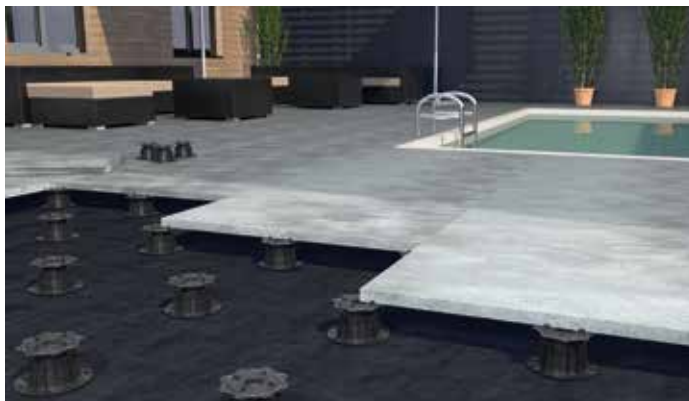
GIANT M zabudowany pod kamiennym tarasem.
